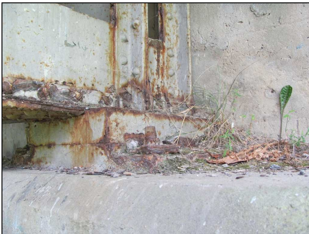
Zdj.17 Łożysko od strony dolnej wody (lewy brzeg) - widoczne zanieczyszczenia, złuszczenie powłok malarskich i korozja powierzchniowa elementów.
