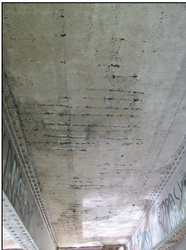
Zdj.29 Płyta pomostu pomiędzy poprzecznicami - widoczne ubytki betonu i "prześwitujące" zbrojenie (brak odpowiedniej otuliny).
