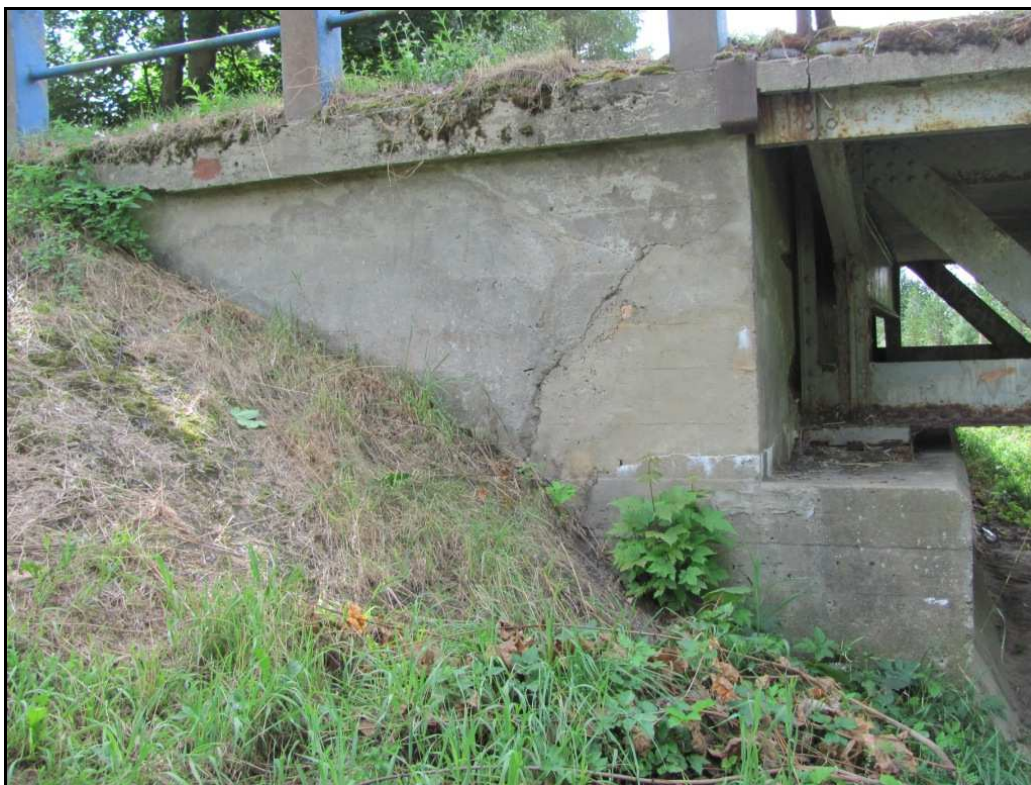
Zdj.15 Skrzydelko prawobrzeżne od strony dolnej wody - widoczne spękania z ubytkami betonu, wegetacja mchów na gzymsie.
