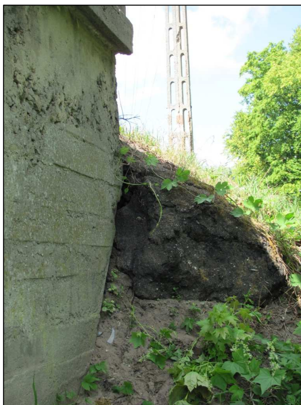
Zdj.14 Skrzydełko lewobrzeżne od strony dolnej wody - widoczny ubytek stożka nasypu i odsłonięte skrzydło, co zagraża stateczności i trwałości podpory.
