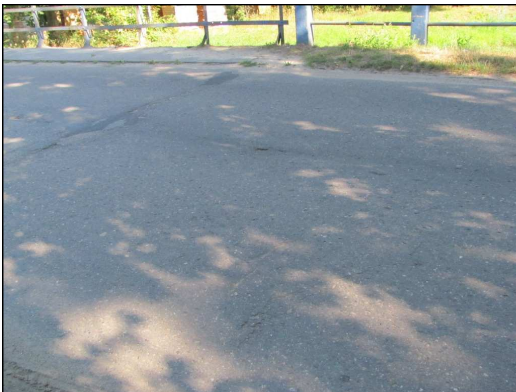
Zdj.6 Nawierzchnia jezdni w obrębie skrzydeł prawobrzeżnych - widoczne deformacje i spękania oraz pojedyncze ubytki.
