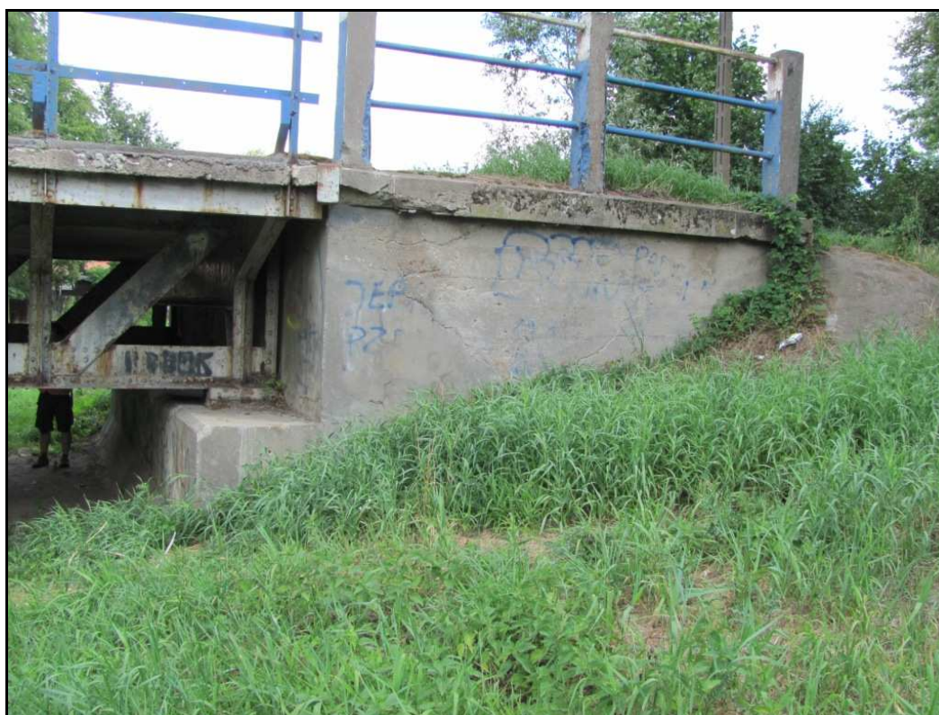
Zdj.16 Skrzydło prawobrzeżne od strony górnej wody - widoczne wykruszenia i ubytki betonu, spękania. Koniec skrzydła odsłonięty - brak odpowiedniego obsypania.
