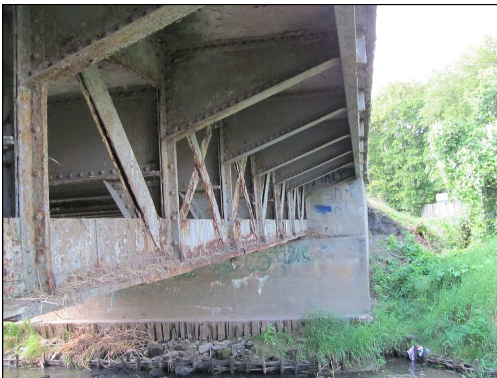
Zdj.27 Stalowa nitowana konstrukcja stalowa - widoczne zanieczyszczenia, złuszczenie powłok malarskich i korozja powierzchniowa elementów stalowych.
