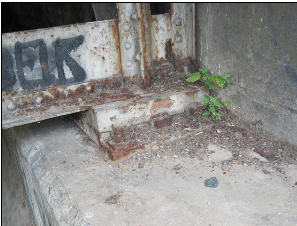
Zdj.19 Łożysko od strony górnej wody (prawy brzeg) - widoczne zanieczyszczenia, złuszczenie powłok malarskich i korozja powierzchniowa elementów.
