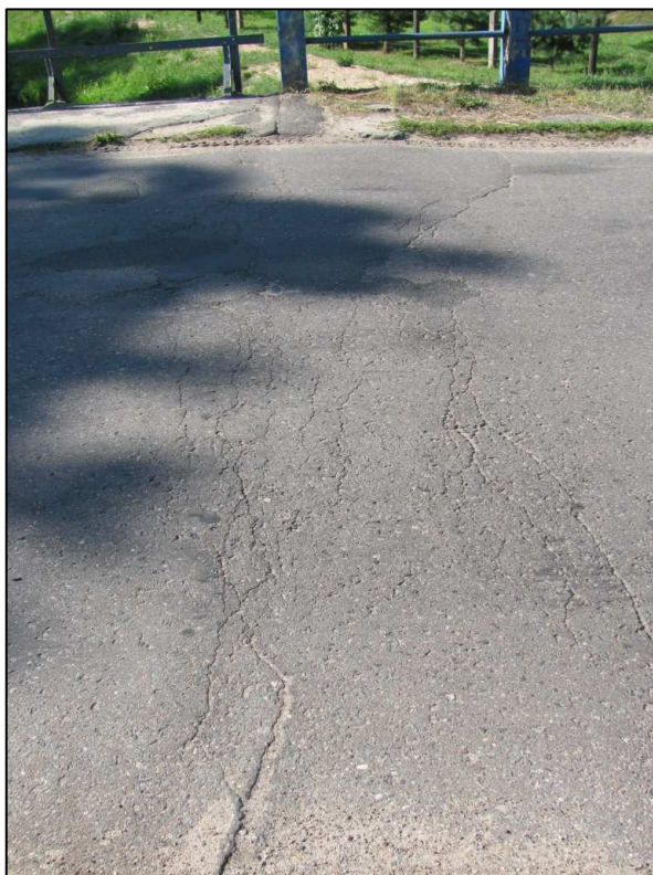
Zdj.7 Nawierzchnia jezdni w obrębie skrzydeł lewobrzeżnych - widoczne deformacje, obniżenie nawierzchni na styku obiekt-najazd, spękania.
