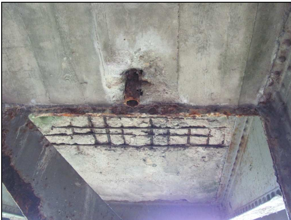
Zdj.31 Płyta pomostu - widoczne ubytki betonu oraz osady wokół rury spustowej. Widoczna również korozja betonu i odsłonięte zbrojenie wspornika podchodnikowego.
