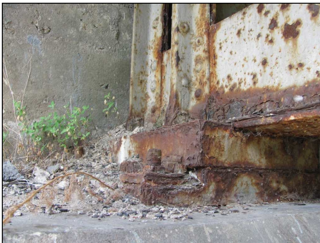
Zdj.18 Łożysko od strony górnej wody (prawy brzeg) - widoczne zanieczyszczenia, złuszczenie powłok malarskich i korozja powierzchniowa elementów.
