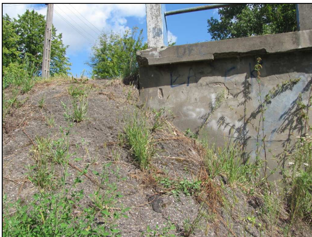
Zdj.13 Skrzydełko lewobrzeżne od strony górnej wody - widoczne odsłonięcie skrzydełka, ubytki betonu ściany i gzymsu, spękania i pęknięcia.
