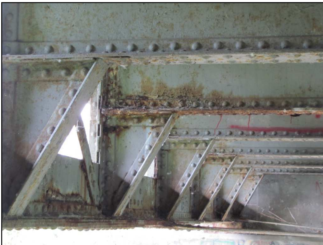
Zdj.25 Stalowa nitowana konstrukcja stalowa - widoczne złuszczenie powłok malarskich i korozja elementów stalowych.
